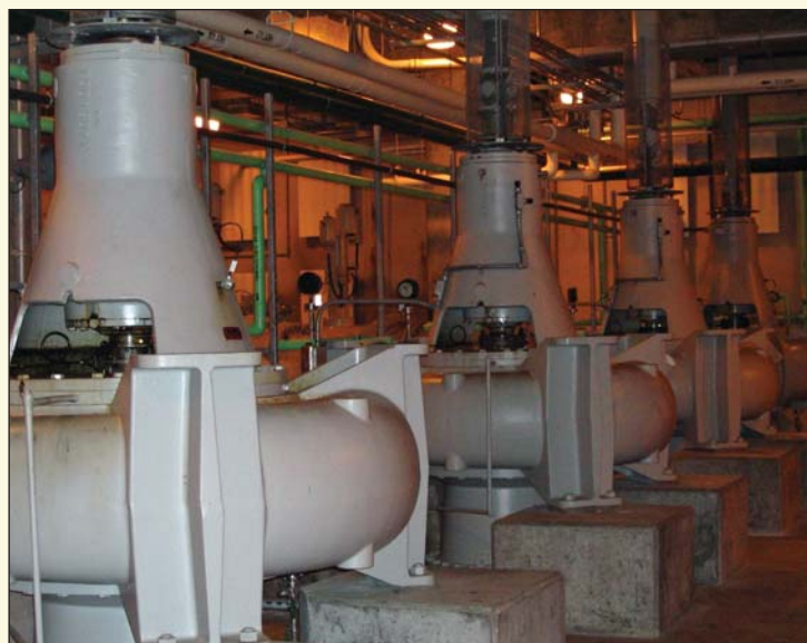
Ces pompes à effluents, dont l'étanchéité est assurée par des garnitures mécaniques en deux parties de 200 mm (8,00 po) de diamètre, sont en service depuis plus de 12 ans.
