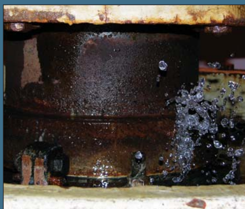
Les fuites entraînent la corrosion des équipements et la rupture prématurée des paliers
